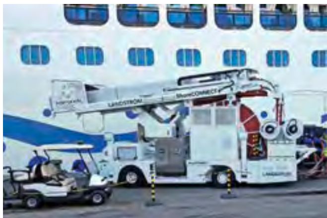
Die ganz großen Steckdosen. Die AIDAnova am 26. August 2023 vor dem Auslaufen aus Kiel an der Landstromversorgung. Foto: Felix Kolbeck
