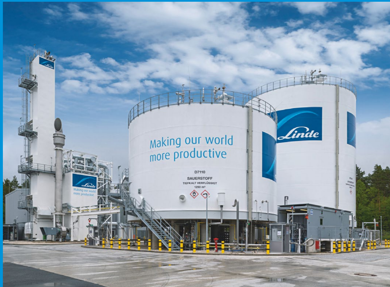
Linde Luftzerlegungsanlage in Röthenbach
