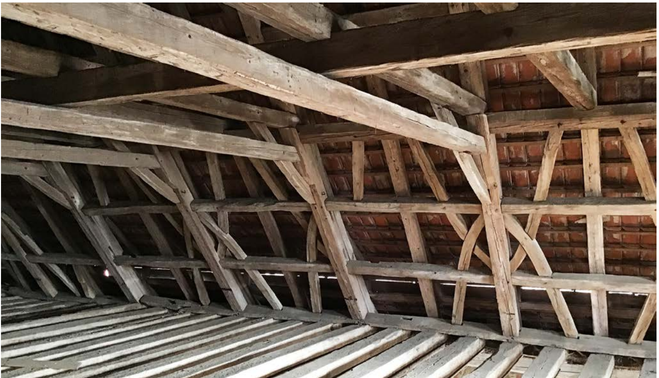
Bauen im historischen Kontext, Bauaufnahme Gutshof Rossrieth bei Mellrichstadt, mit LB Reinhold Winkler, SS 2019, Dachstuhl Schloss Rossrieth
